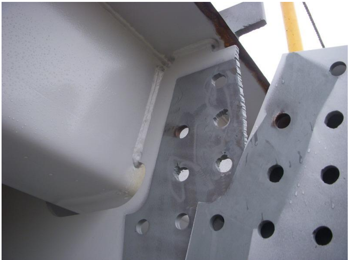
圖片 3-13((預裝精度不良現場不當開孔)
