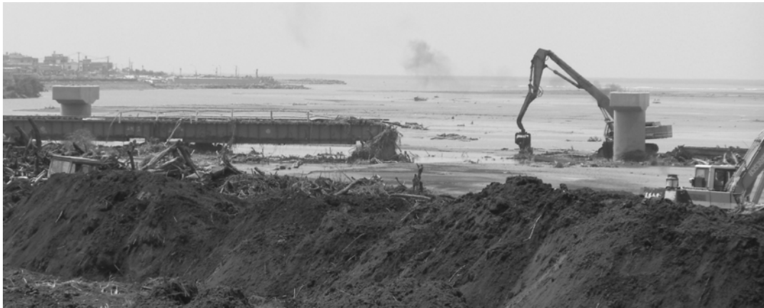
圖八 林邊鐵路斷橋
