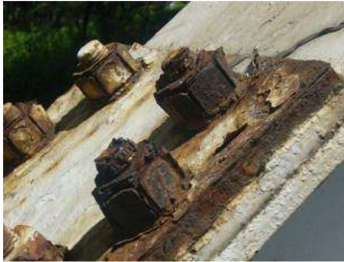
圖二 螺栓未即時補修而導致螺帽生銹開花
