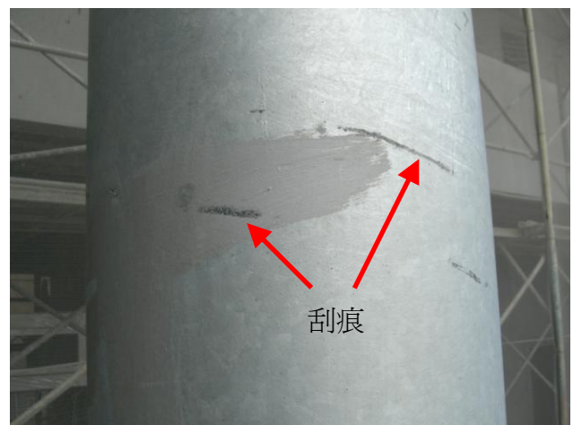
圖三 熱浸鍍鋅層刮傷情形
