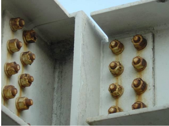
圖六 公共管架之扭斷型 F10T 高強度螺栓無熱浸鍍鋅下已生銹
