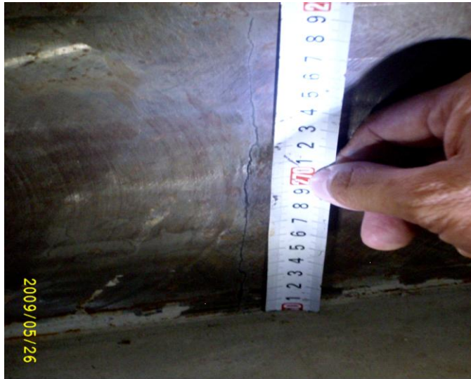
圖六 目視檢測(VT)裂縫狀況
