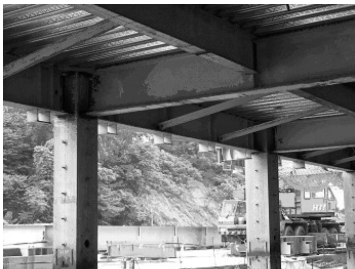
圖 10-1 鋼結構建築之快速銹蝕
