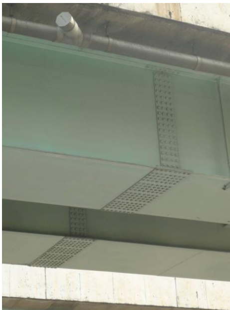
圖 5：箱型鋼梁腹板接合螺栓數量較翼板接合螺栓數量多之案例。
