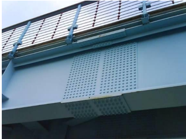
圖 3：H 型鋼梁腹板接合螺栓數量較翼板接合螺栓數量多之案例。
