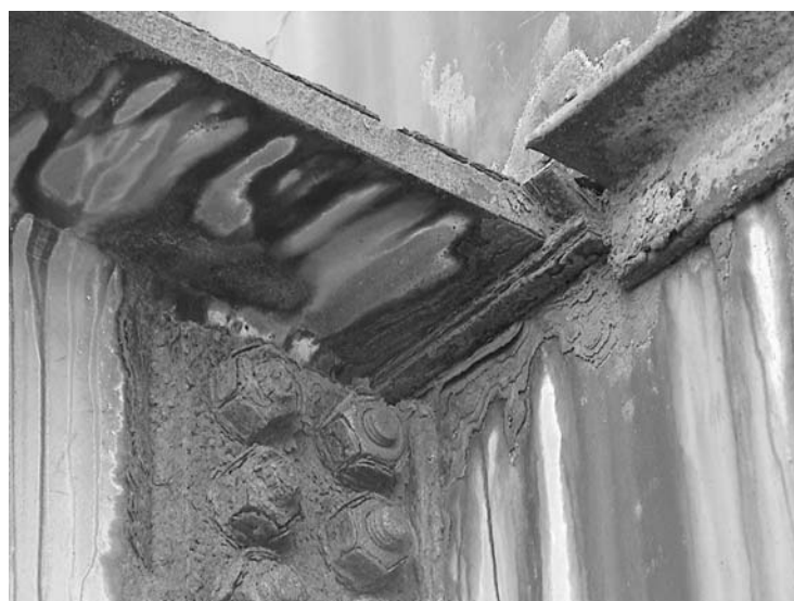
圖 8-1 多層建築之嚴重銹蝕 [1]
