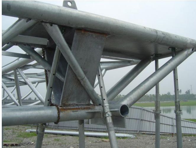
圖 3 切割修改造成的燃燒破壞
