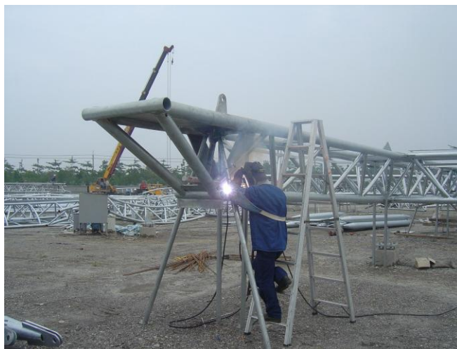
圖 2 銲接造成的燃燒破壞
