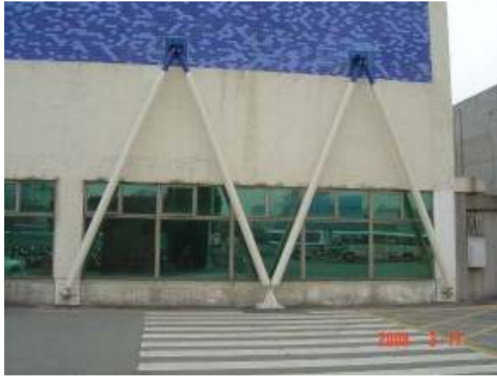
圖十二 無鋼框架之斜撐造成錨定點力量集中之現象。
